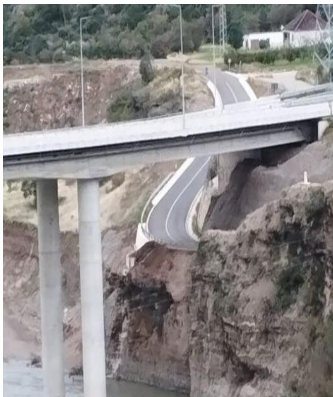
Slika br.2.13. Klizište na autoputu
