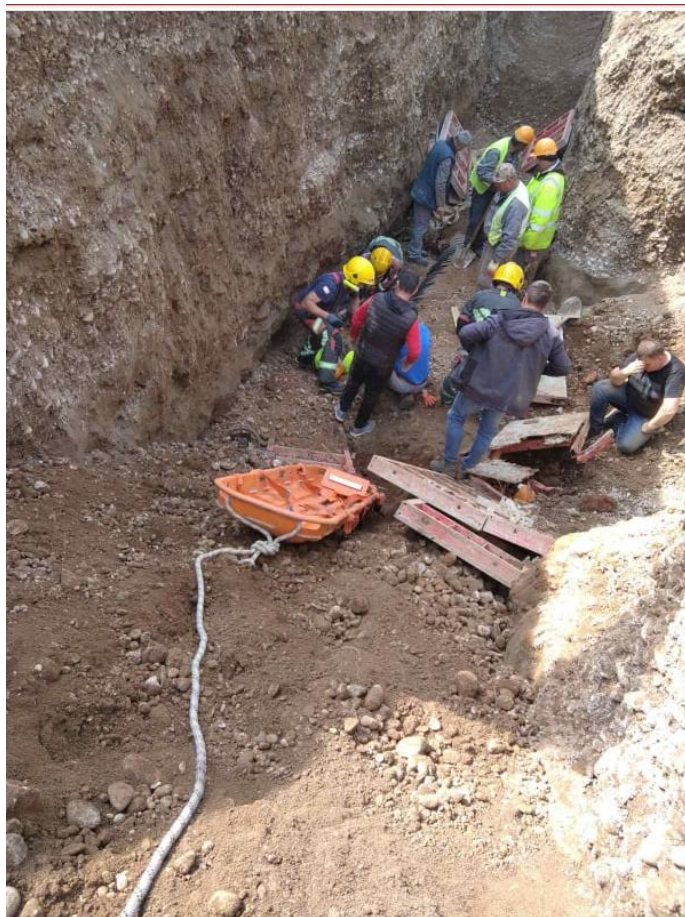
Slika br. 2.12. Odron na gradilištu u Gornjoj Gorici-Izvor: Služba zaštite i spašavanja Podgorica
